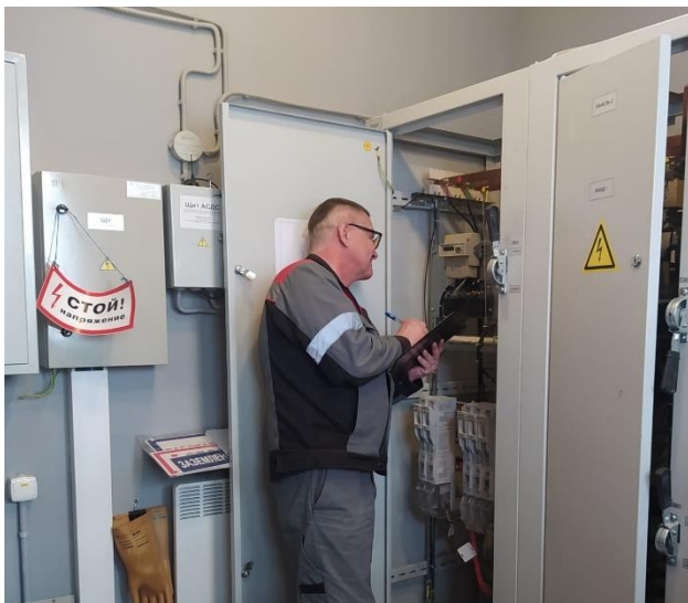
ТО инженерных систем ул. Академика Павлова, д. 6
